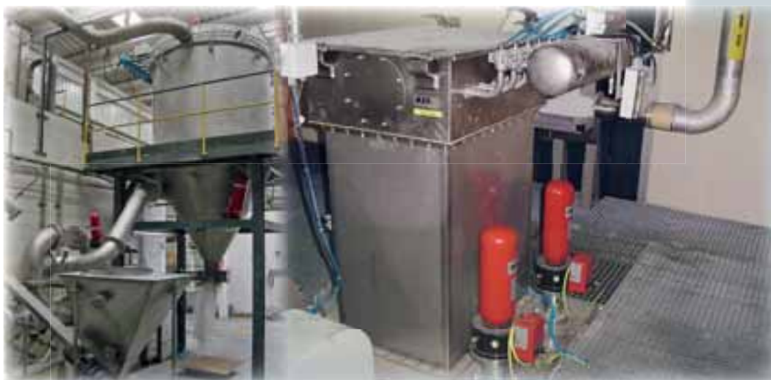
Instalación protegida mediante supresión de explosiones.
