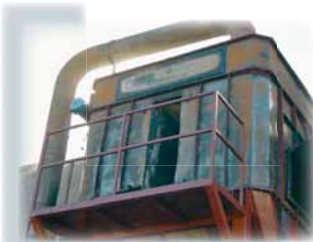
Consecuencias de la explosión de un filtro causada por el molino de martillos.
