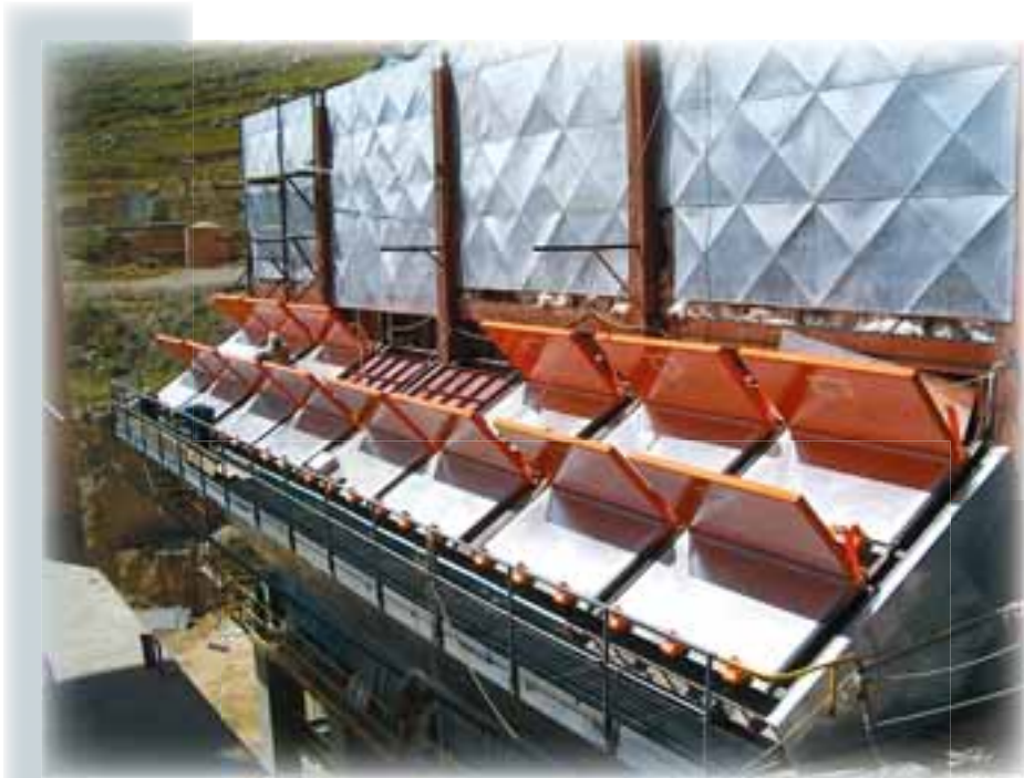
Filtro de mangas protegido con puertas de venteo de explosiones.
