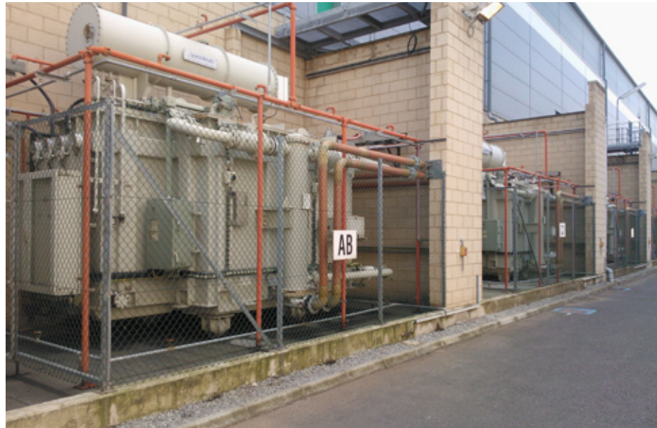
Figura 3.4. Los módulos de transformadores
