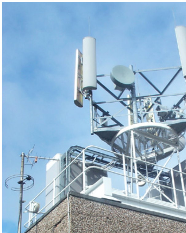
Figura 10.1. Antenas sectoriales de telefonía móvil y una antena de disco para transmisión de microondas en el tejado de la caja del ascensor
