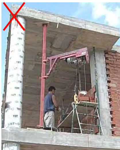
Trabajador con riesgo de caída a distinto nivel.
