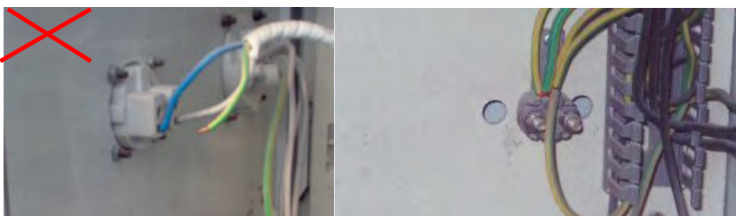
En la fotografía de la izquierda se ha interrumpido la continuidad del conductor de puesta a tierra
